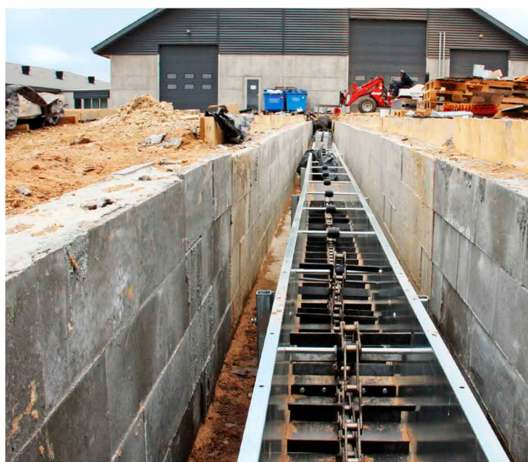
■ Kæderedleren er placeret under jorden og har en kapacitet på 80 tons. Den kan transportere kornet fra siloanlægget til foderladen og omvendt.
